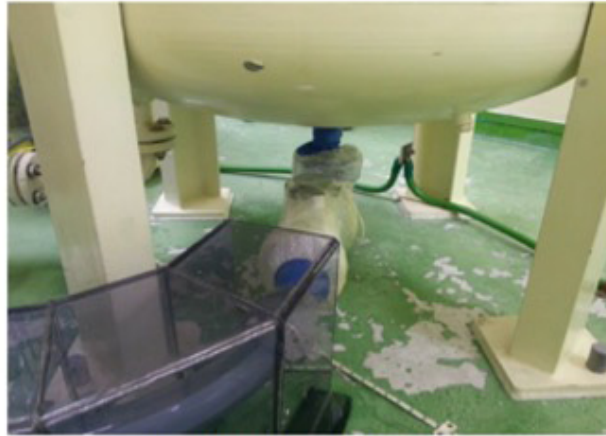
[사진 1] 누출이 발생한 불산탱크 하부 모습
